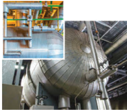
DEGAZÖR VE KONDENS TANKI
